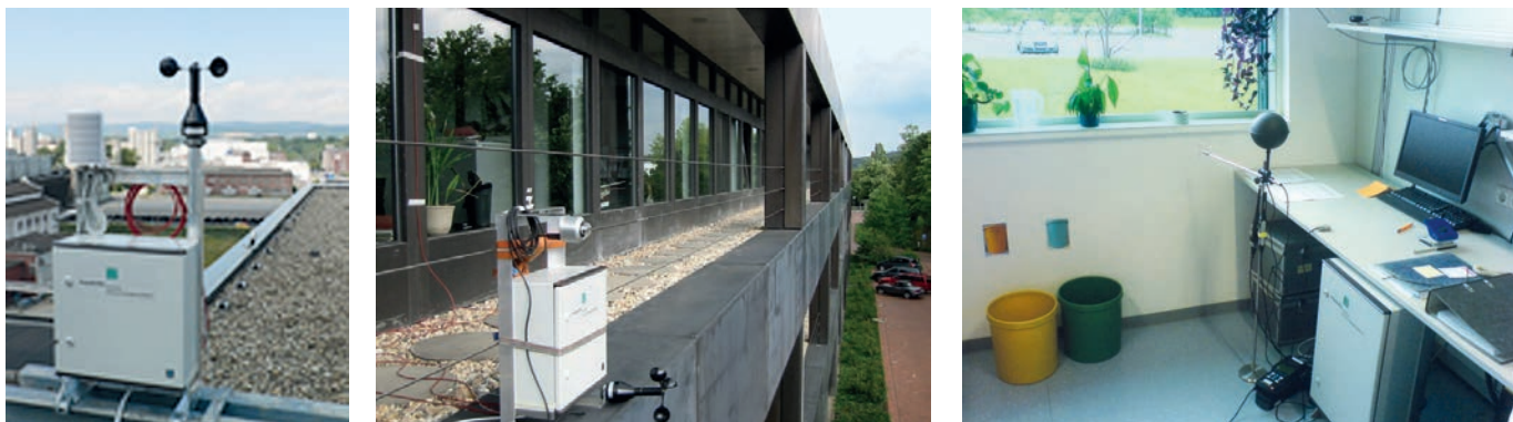
Bild 1. Mobile Messtechnik zur Datenerfassung, -speicherung und -übertragung von Wetter (links), Mikroklima an der Fassade (Mitte) und Raumklima (rechts)
