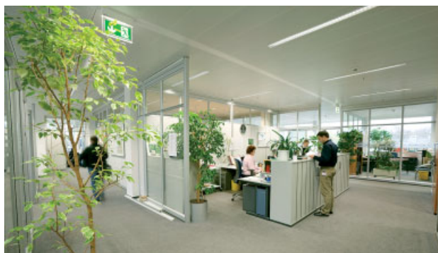
Bild 3. PFIZER, Freiburg (NGF 6880 m 2 ): geschlossene Kühldecke (Quelle: Fototeam Vollmer)
