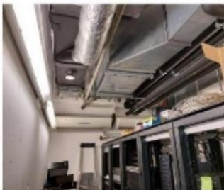
Klimasplitgeräte in Serverräumen
