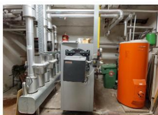
Kessel mit WW-Bereiter
