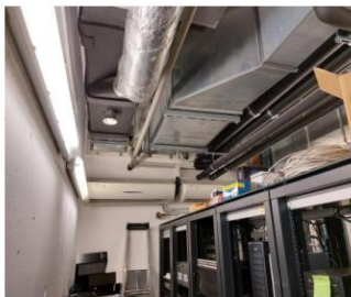
Klimasplittergeräte in Serverräumen
