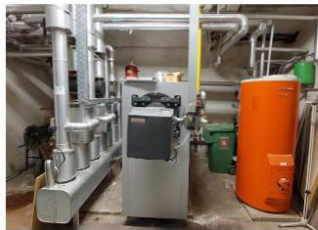
Kessel mit WW-Bereiter
